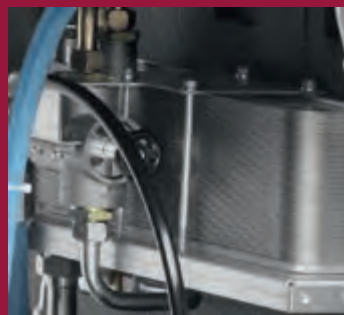
rekuperacija toplote za pripravo tople vode
